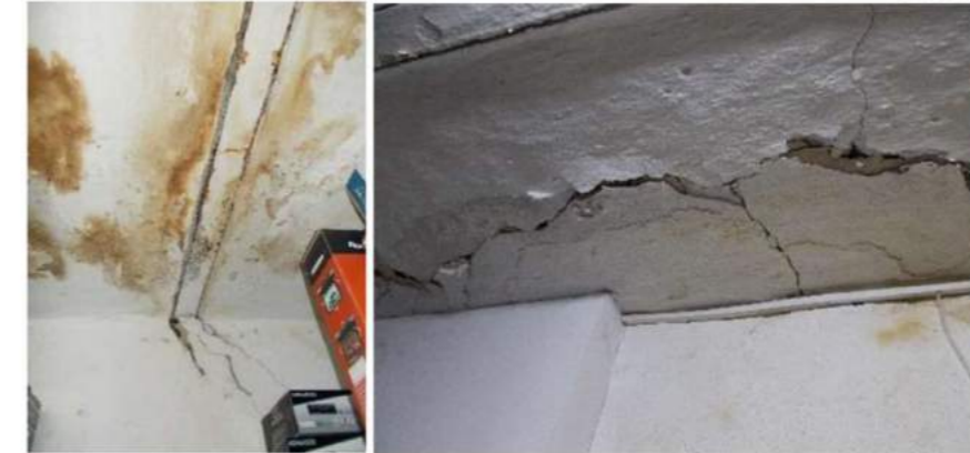
איור 33- התקלפות שכבת הטיח בתקרה וכתמי רטיבות
