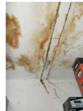
איור 30- קורת תמיכת תקרה חלודה
