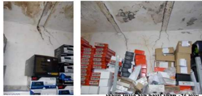
איור 26 - סדקי גזירה קיר פנימי מערבי
