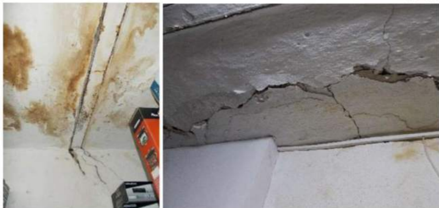
איור 33- התקלפות שכבת הטיח בתקרה וכתמי רטיבות
