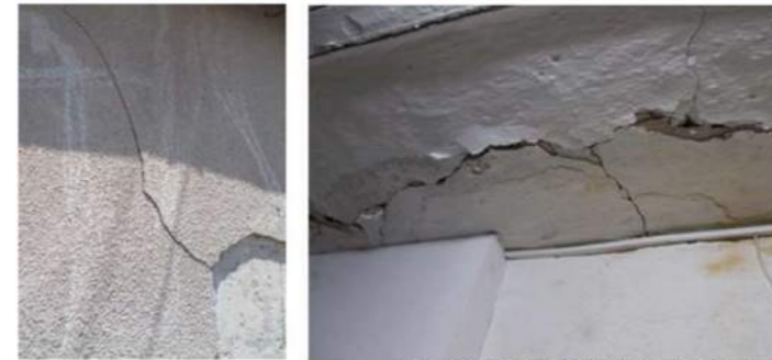
איור 27 - סדק אופקי לאורך קורת פלדה איור 28 - סדק בטיח צמנטי חזית מערבית
